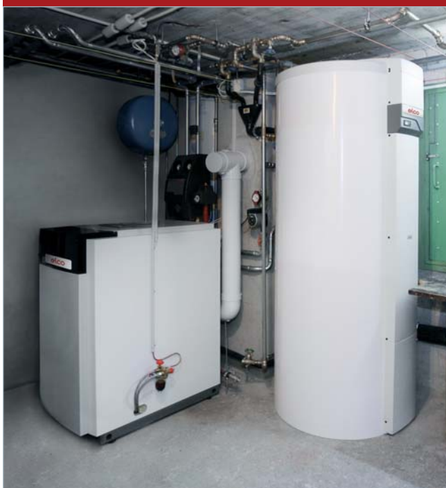
Un coup d'oeil à la chaufferie au sous-sol
