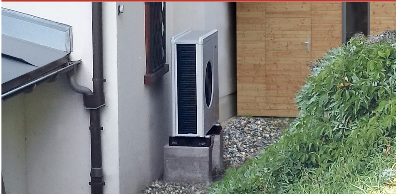
Der Verdichter und der Verdampfer des Luft-Wasser-Wärmepumpen-Splitsystems befinden sich in der Ausseneinheit.
