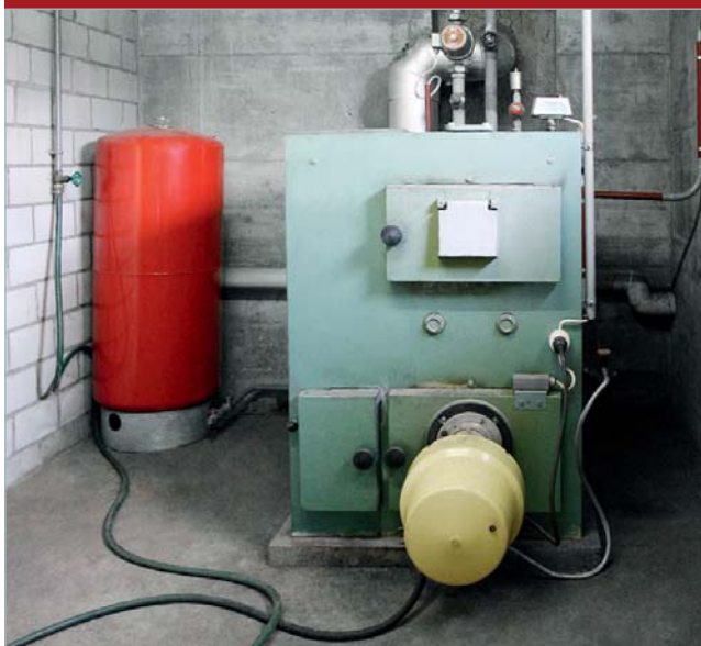
Die alte Ölheizung diente als Heizzentrale für die 3 Terrassenhäuser.
