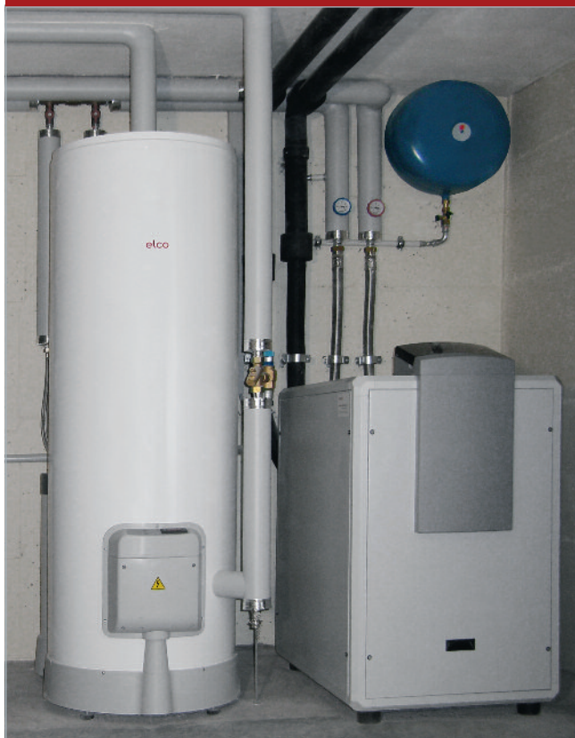
Blick auf die ELCO Wärmepumpe
