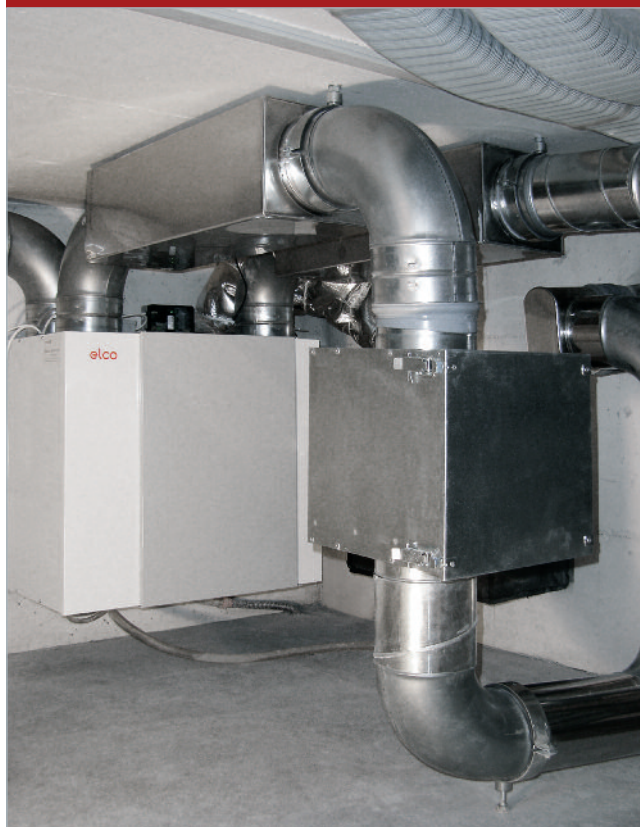
Blick auf die ELCO Komfortlüftung
